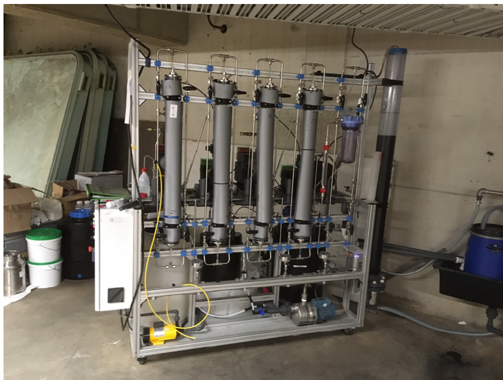
Figuur 4: Opstelling van de Diagnosetool in Kralingen, met rechts de extra AKF-behandeling van het effluent van de kolommen
